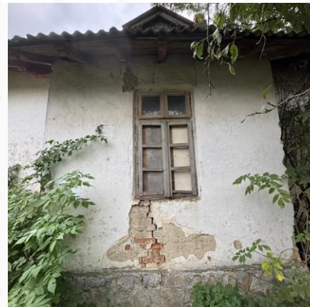
Fracturi în zidărie.
